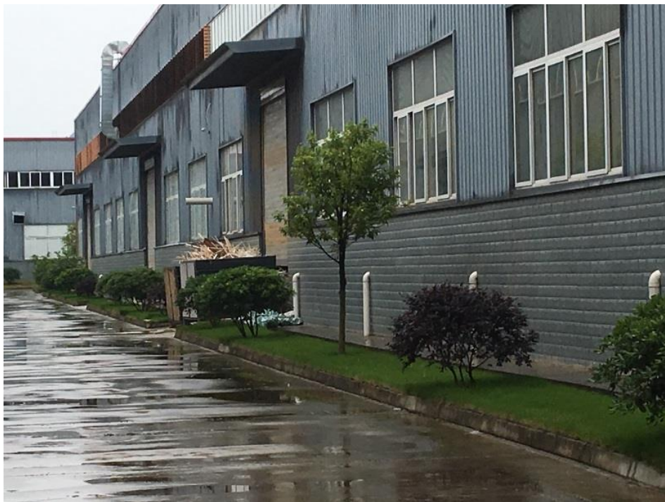
照片 3-3 一般固废暂存点
